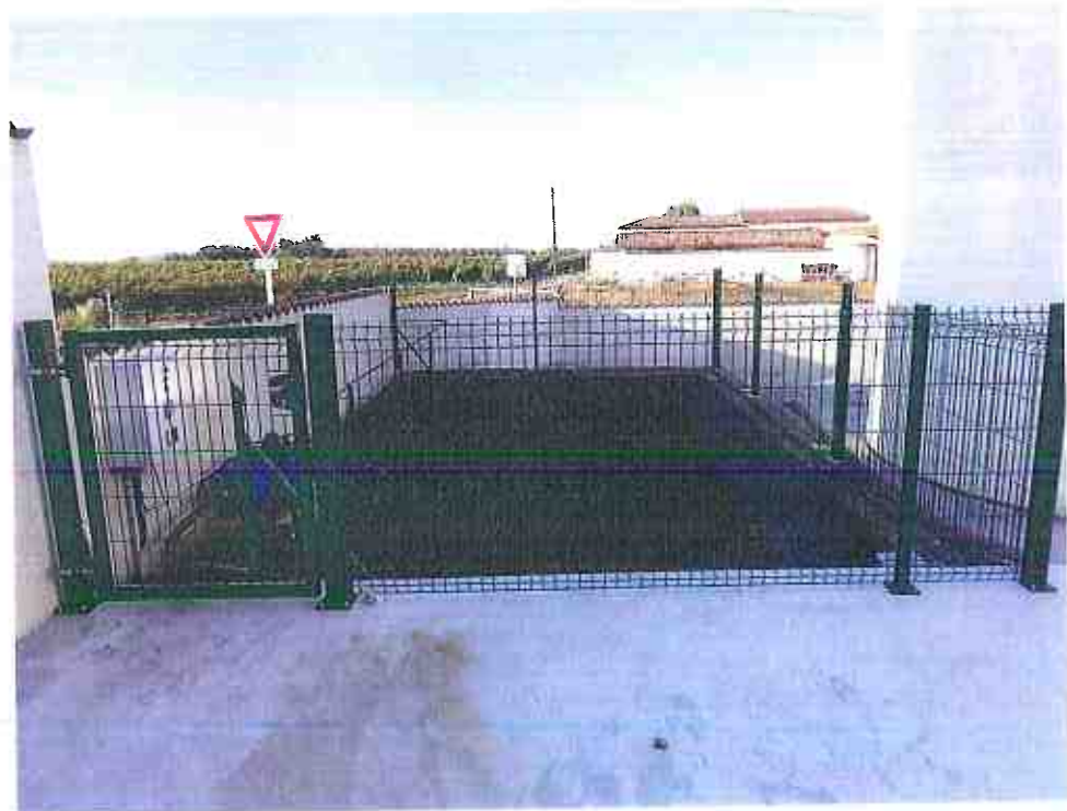
Figure 11 : Bassin de stockage des vinasses en béton semi-enterré avec membrane en polyéthylène d'une capacité de 80 m 3
